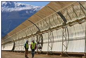
Solarthermie-Kraftwerk in Granada, Spanien. (Bild: Keystone)
